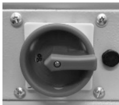
Abb. 3: Not-Halt = Hauptschalter, Outdoor, mit Wetterschutzkasten
