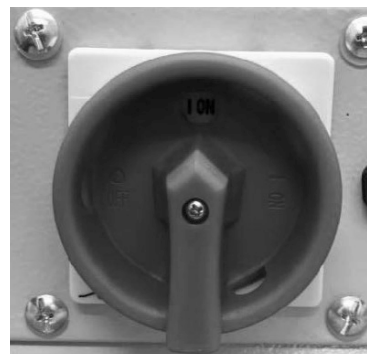
Abb. 58: Einschalten der Steuerung
