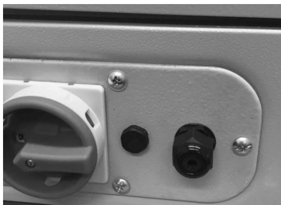
Abb. 56: Ansicht PG-Verschraubung Wetterschutzkasten
